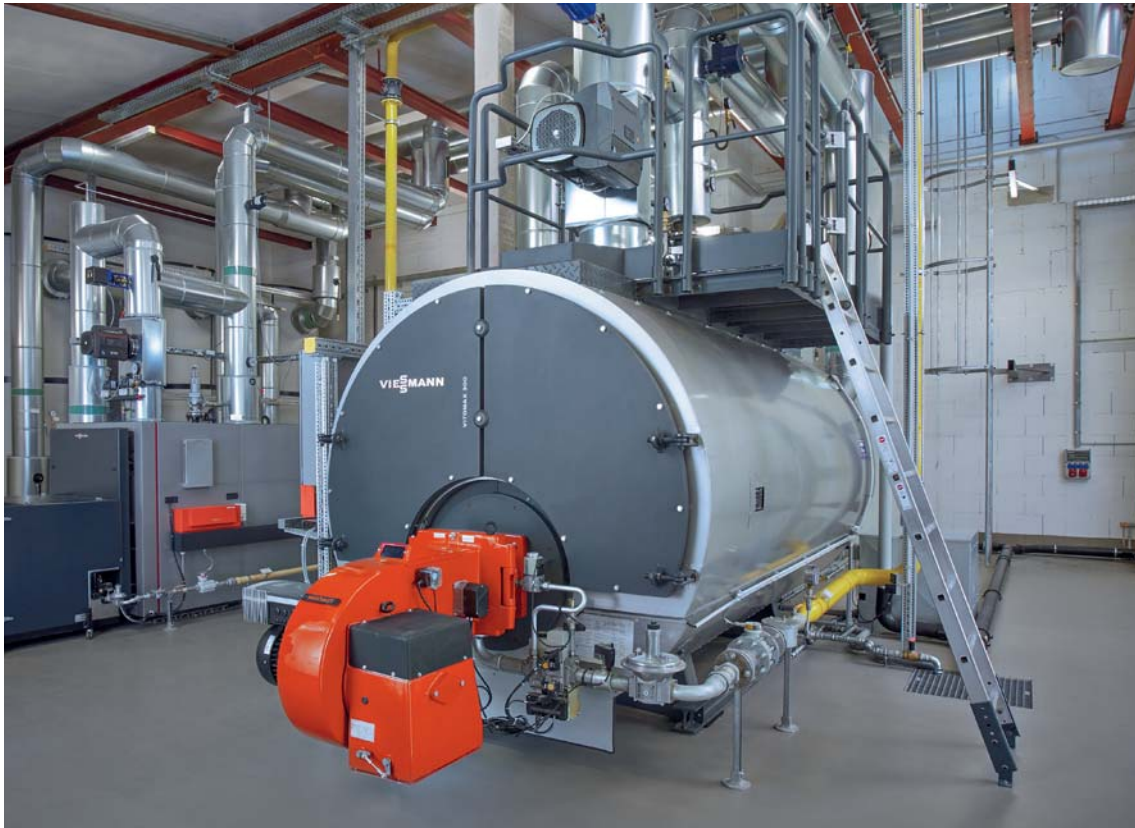
Heißwasserkessel Vitomax LW (2300 kW) und Niedertemperatur- Heizkessel Vitoplex 200 (700 kW)
