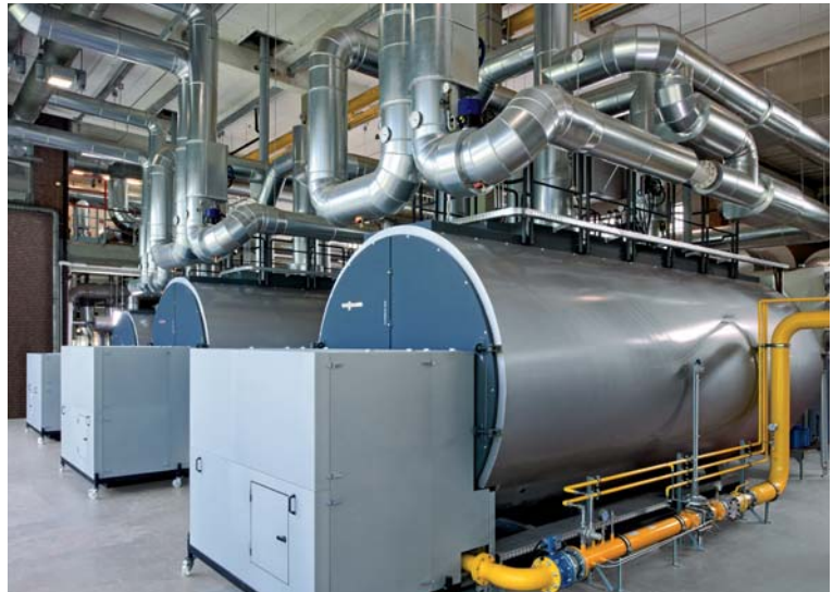
Drei Niederdruck-Heißwassererzeuger Vitomax LW leisten zusammen 32 MW
